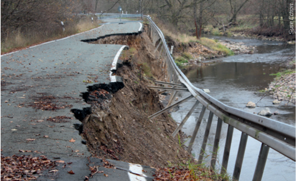
Die verheerenden Schäden der Wassermassen.
